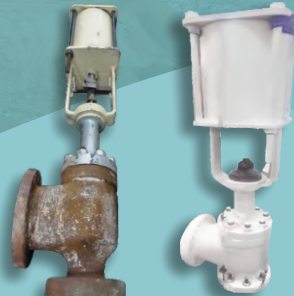
Válvulas de control con actuador neumático
